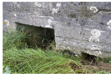
Détail de l'entrée nord. A sa droite un créneau de fusillade Phot. Jean-Marc Ramette IVR32_20165901478NUCA
