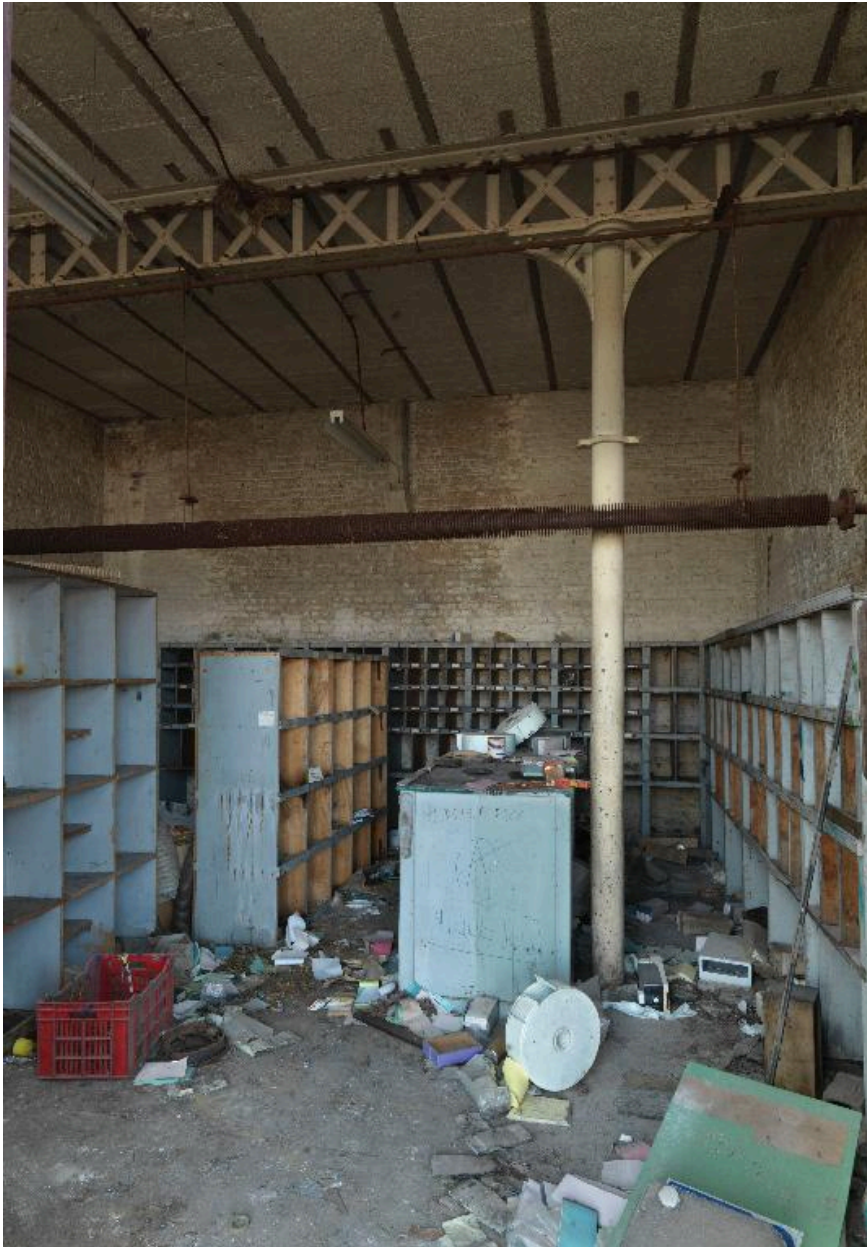
Intérieur de l'atelier des pièces détachées, zone de stockage.
