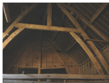
Vue d'une ferme de charpente de la grange. Phot. Inès Guérin IVR22_20068005524NUCA
