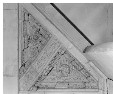
Premier étage de l'aile sud du logis : vue de la voûte qui surmontait au 16e siècle le palier du petit escalier droit. Phot. Thierry Lefébure IVR22_19910200127X
