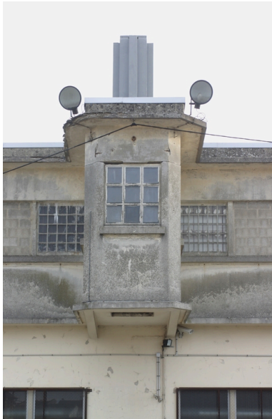
Détail de la façade de la boulangerie (aménagement destiné à l'élévation des sacs de farine vers l'étage).
