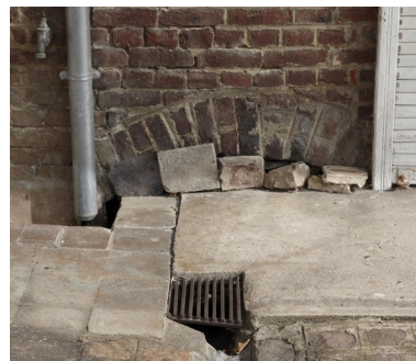
Vue de l'ouverture située sur le revers du second logis, près du cours de l'Aunelle. Phot. Pierre Thibaut IVR31_20095903264NUCA
