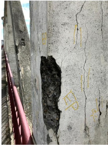
Epaufrure du béton sur l'un des supports verticaux de la passerelle. Phot. Bertrand Fournier IVR32_20170205226NUC2A
