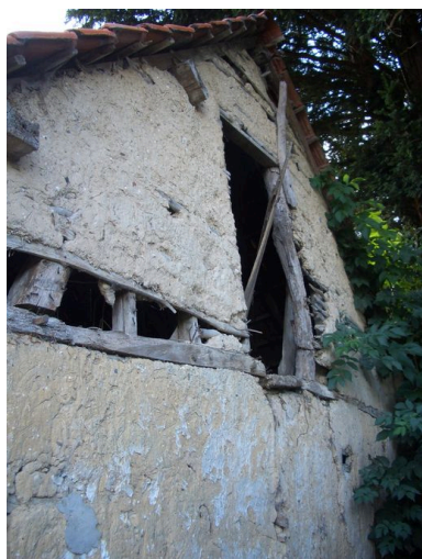
Vue du mur pignon en torchis avec gerbière. Phot. Inès Guérin IVR22_20068005111NUCA
