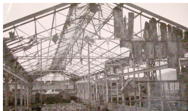
Domages après les bombardements sur le magasin aux fers, 1944 (AD Oise ; 617W18128). Phot. Clarisse Lorieux IVR22_20086005059NUCAB
