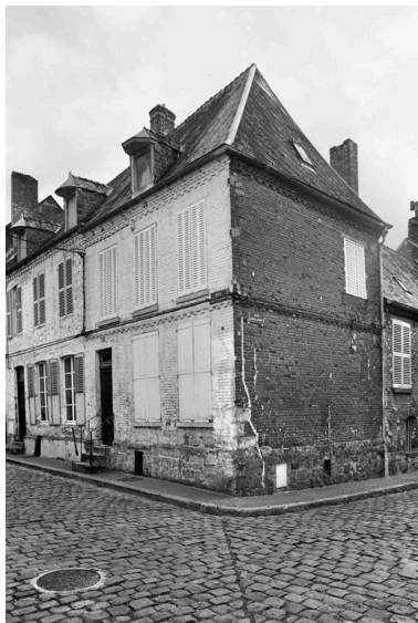
Vue de la maison, prise depuis la grille de la sous-préfecture. Phot. Pierre-Yves Brest IVR22_19990207128Z
