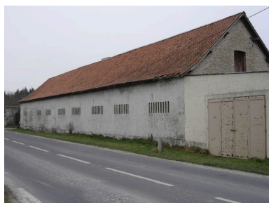
Vue sur la face sud de l'étable (avec ouvertures d'aération). Phot. Catherine Fourmond IVR22_20048001064NUCA
