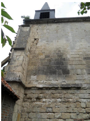
Trace de la baie du mur sud (première travée). Phot. Isabelle Barbedor IVR22_20108010035NUCA
