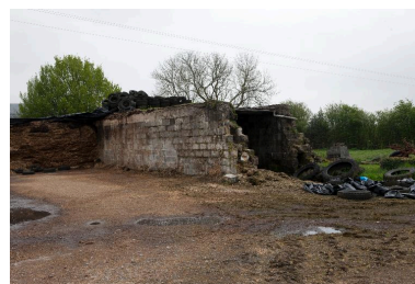
Vue du premier abri de stockage en forme de ski. Phot. Pierre Thibaut IVR31_20126201749NUCA
