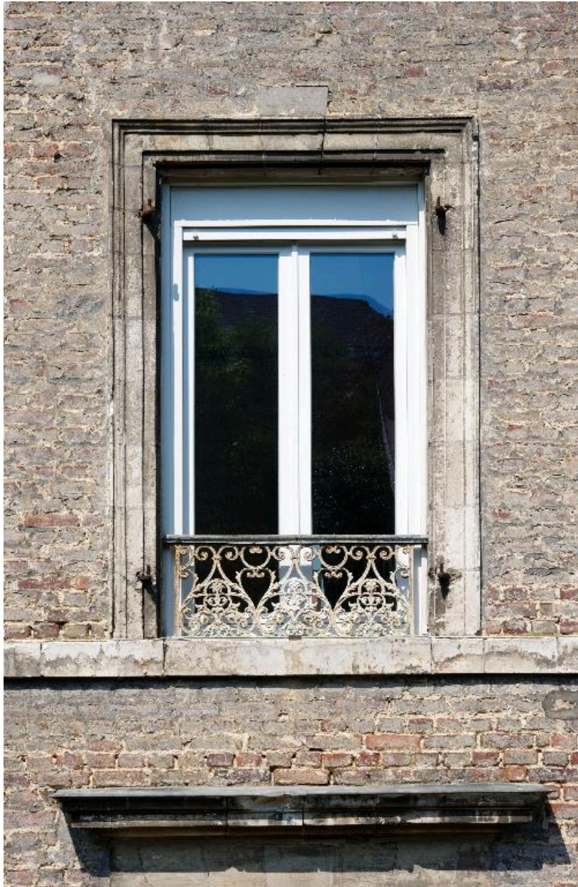
Détail d'une ouverture et de son garde-corps en fer-forgé, premier étage de la façade postérieure.
