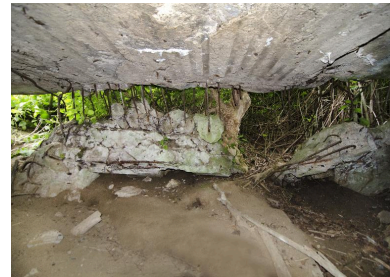
Le mur sud, explosé, de l'intérieur Phot. Jean-Marc Ramette IVR32_20165901170NUCA
