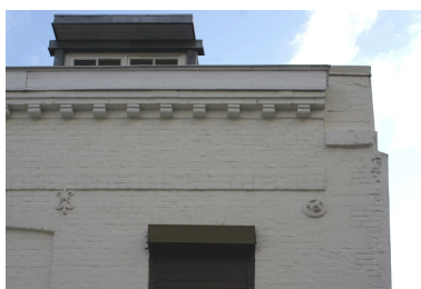
Détail de la façade antérieure : vestiges du pignon est de l'huilerie sur lequel prenaient appui les bureaux. Phot. Frédéric Pillet IVR22_20050205623NUCA
