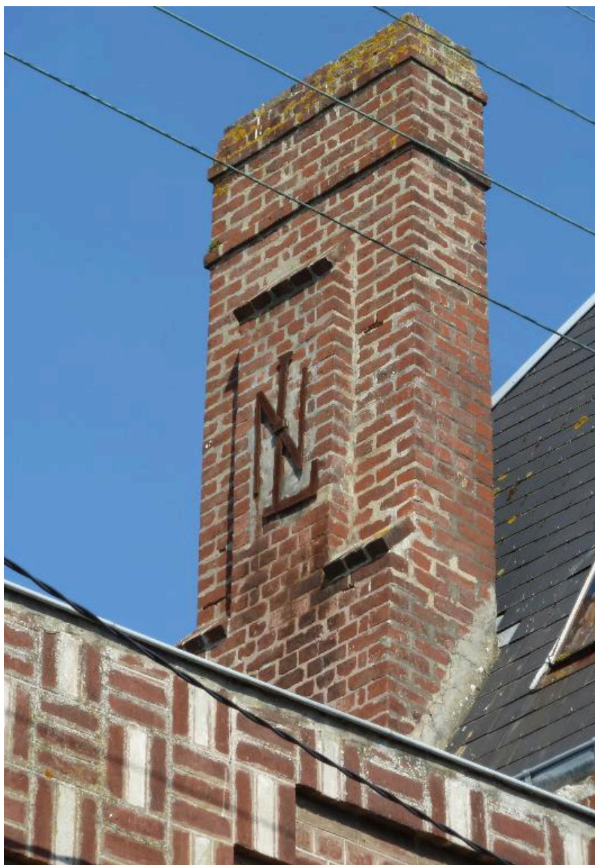
La marque du fabricant LN, en fer d'ancrage sur la souche de cheminée.
