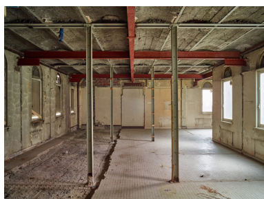
Aile sud, rez-de-chaussée. Vue depuis l'entrée des anciens bains de baignoires à prix réduits pour dames. Phot. Pierre Thibaut IVR32_20165900351NUCA
