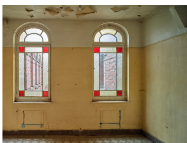
Bâtiment central, premier étage. Logement du directeur : vue de la chambre. Phot. Pierre Thibaut IVR32_20165900364NUCA
