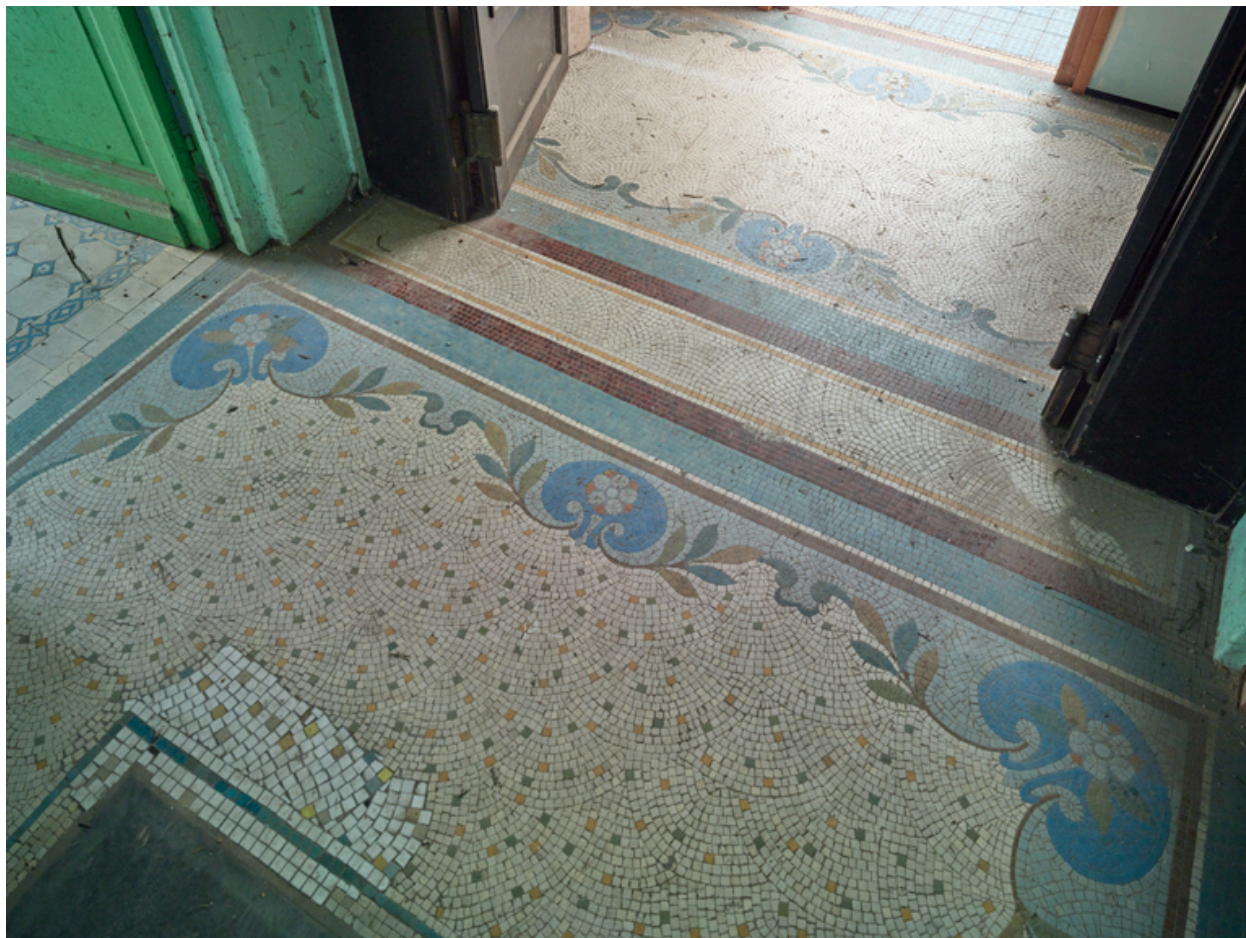
Bâtiment central, rez-de-chaussée. Détail de la mosaïque (entreprise Coilliot) ornant le couloir entre le vestibule et le bassin de natation.
