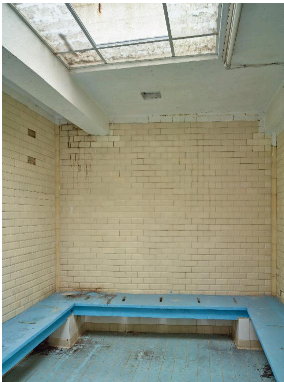
Hydrothérapie du bassin de natation : vue de la salle de vapeur.
