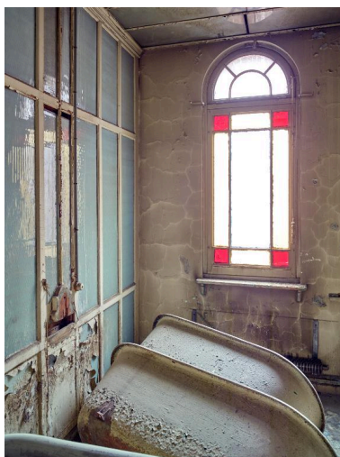
Aile nord, premier étage. Bains de baignoires de luxe pour hommes. Vue de trois quarts de la deuxième cabine à gauche.
