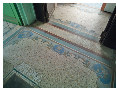
Bâtiment central, rez-de-chaussée. Détail de la mosaïque (entreprise Coilliot) ornant le couloir entre le vestibule et le bassin de natation. Phot. Pierre Thibaut IVR32_20165900367NUCA
