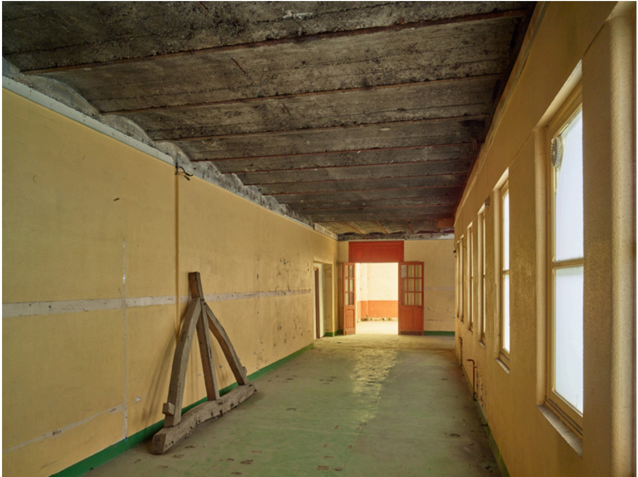
Aile nord, rez-de-chaussée. Vue de l'ancienne hydrothérapie des bains de baignoires de luxe pour dames, remaniée.
