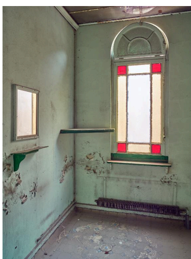
Aile nord, premier étage. Bains de baignoires de luxe pour hommes, première cabine à gauche. Phot. Pierre Thibaut IVR32_20165900395NUCA
