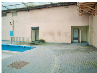
Détail de l'entrée de l'hydrothérapie du bassin de natation. Phot. Pierre Thibaut IVR32_20165900391NUCA
