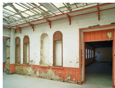
Bâtiment technique, rez-de-chaussée. Vue des baies de l'ancienne hydrothérapie des bains de baignoires de luxe pour dames, donnant sur la cour intérieure.
