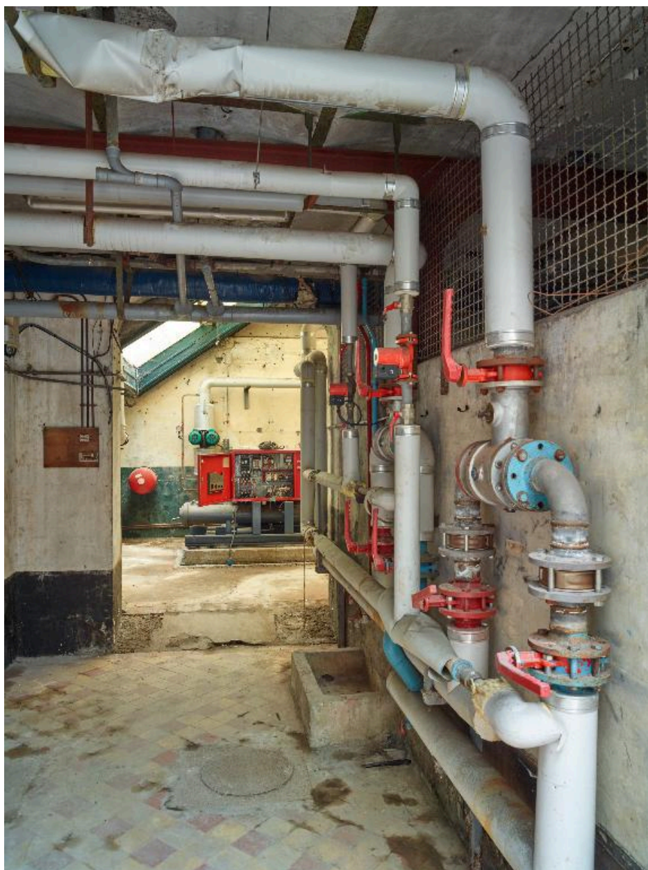
Aile sud, sous-sol. Vue partielle de la machinerie contemporaine au sud de la cour vitrée.
