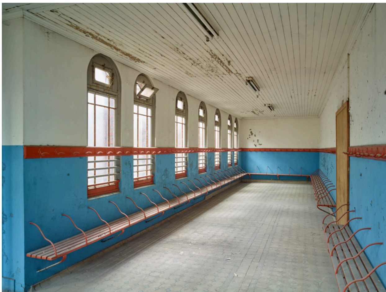
Aile nord, premier étage. Ancienne hydrothérapie des bains de luxe pour hommes, réaménagée en vestiaire collectif. Vue vers le sud.
