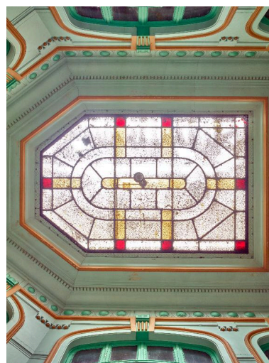
Bâtiment central. Vue de la verrière du vestibule. Phot. Pierre Thibaut IVR32_20165900363NUCA
