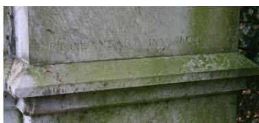
Signature de l'architecte Pierre Ansart (au bas du pilastre droit) et date M CM VII. Phot. Caroline Vincent IVR22_20078001192NUCA
