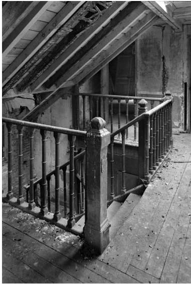
Vue de la cage d'escalier de la maison. Phot. Pierre-Yves Brest IVR22_19990204139Z
