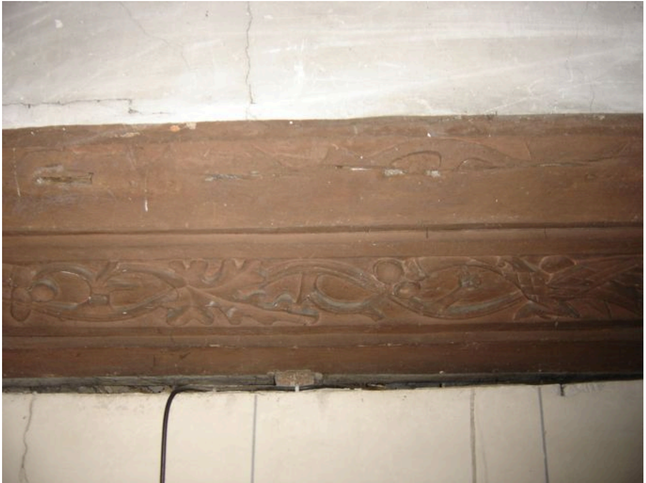
Détail du décor de pampre de la sablière haute du bas-côté nord.
