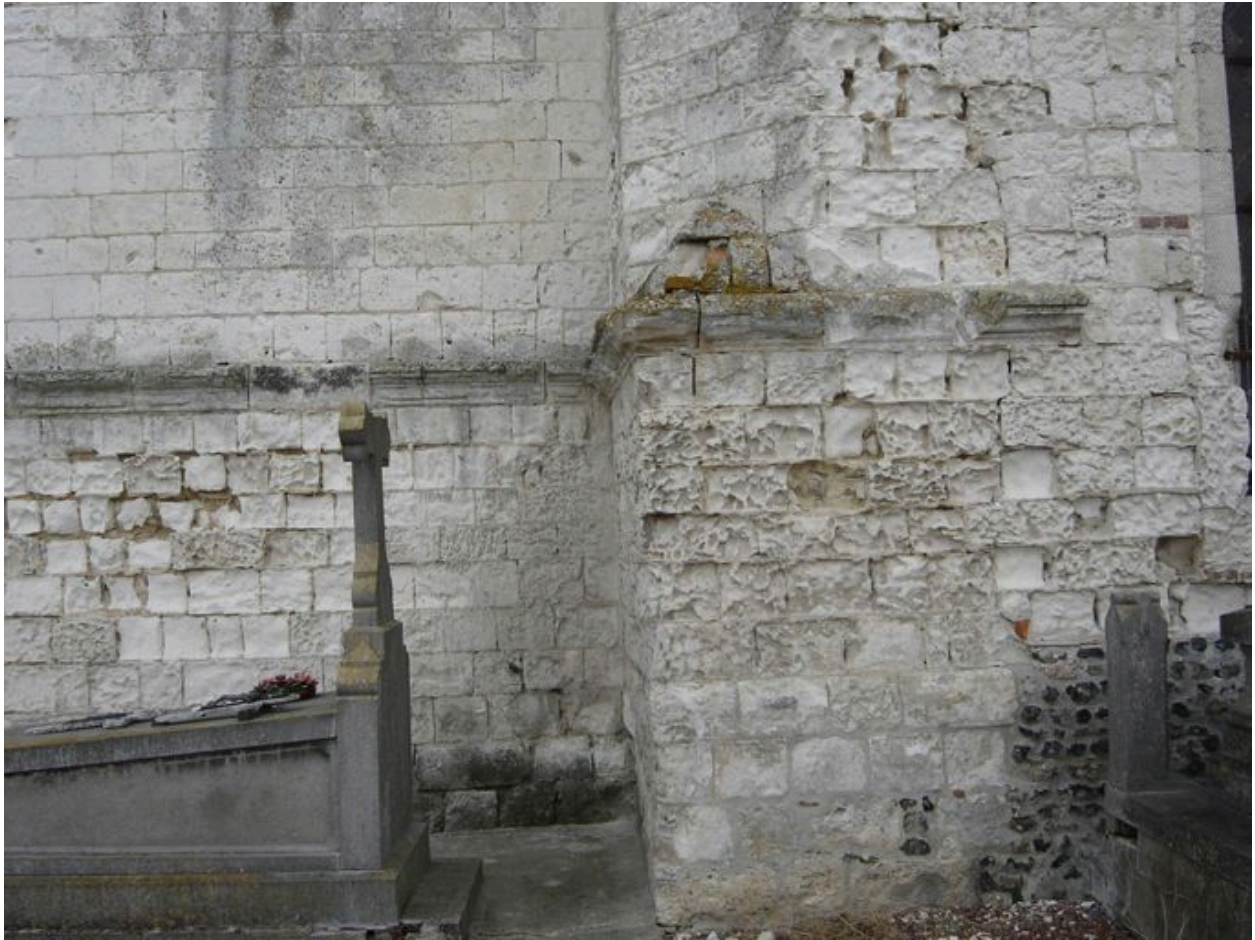
Vue partielle du mur nord dont la maçonnerie est littéralement attaquée par l'érosion éolienne.
