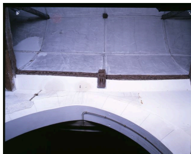
Vue détaillée d'une partie de la sablière basse du mur sud du bas-côté nord. Phot. Irwin Leullier IVR22_20068000555XA
