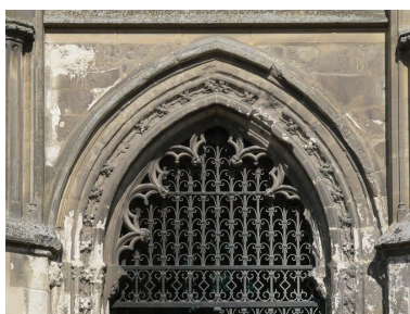
Dormant de la clôture du portail Saint-Quentin. Phot. Christiane Riboulleau IVR22_20110201080NUCA
