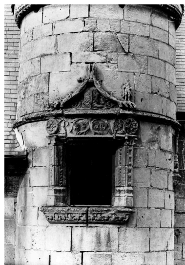
Détail d'une baie ornée de la tourelle d'angle, avant 1914 (AP). Repro. Monnehay-Vulliet Marie-Laure IVR22_20096000454NUCA
