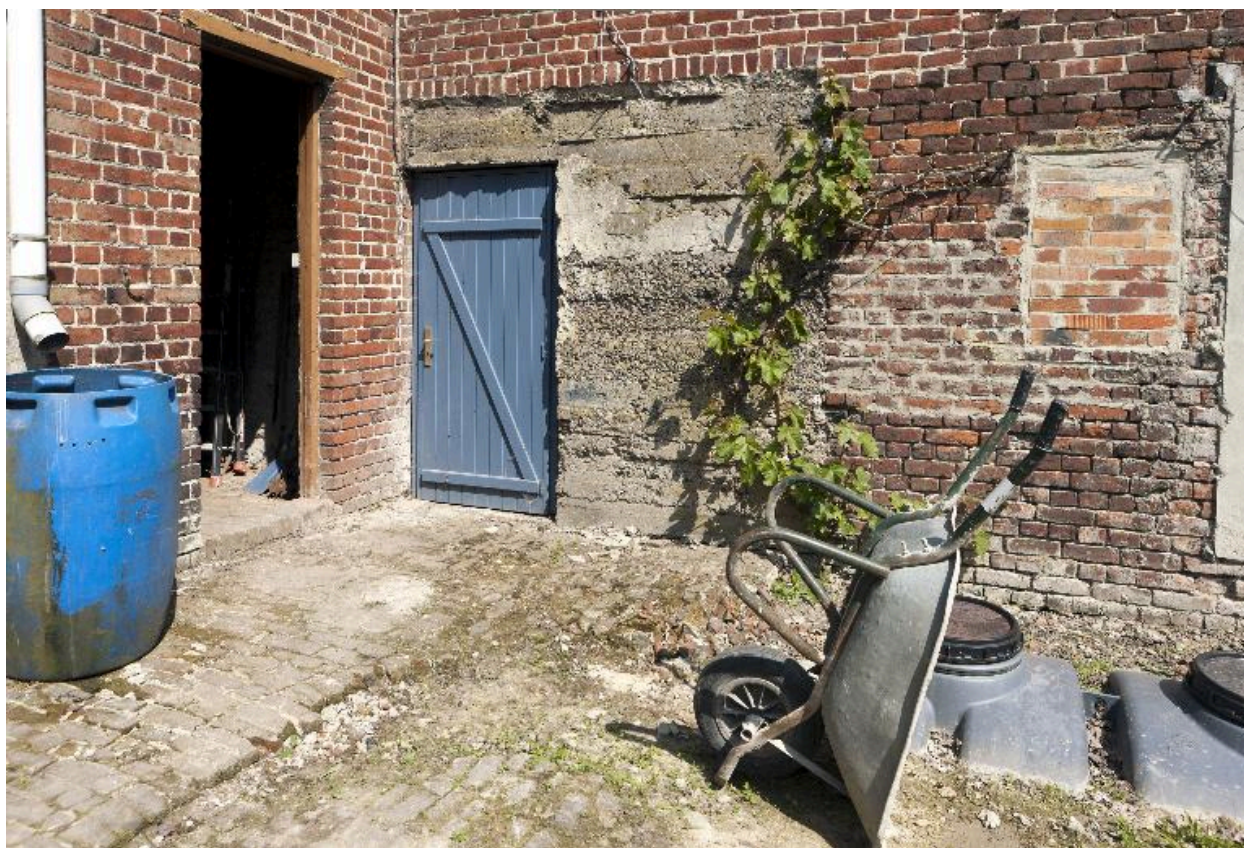
Entrée de la casemate sur la cour de la ferme, vers le nord.
