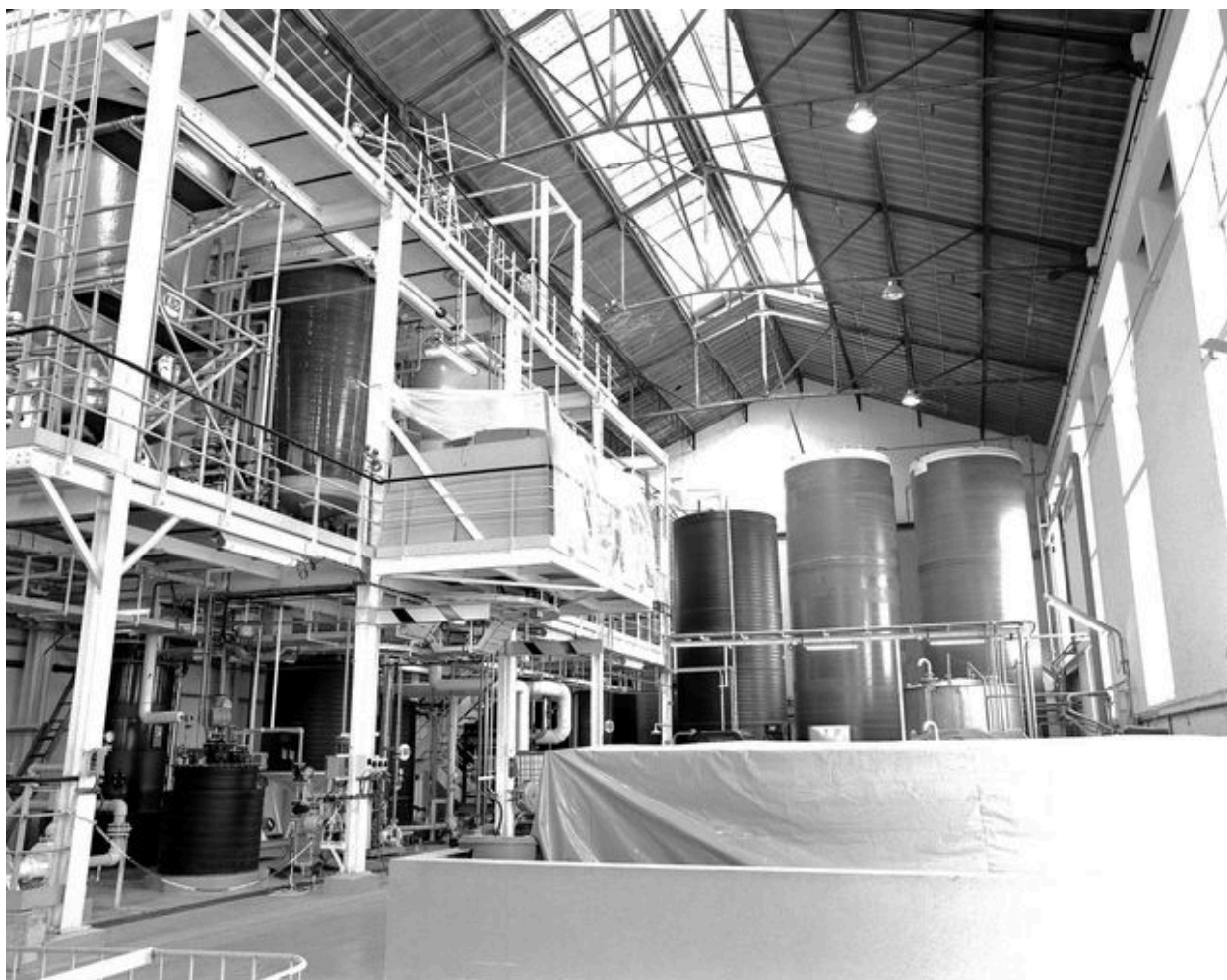
Chaufferie : vue intérieure.
