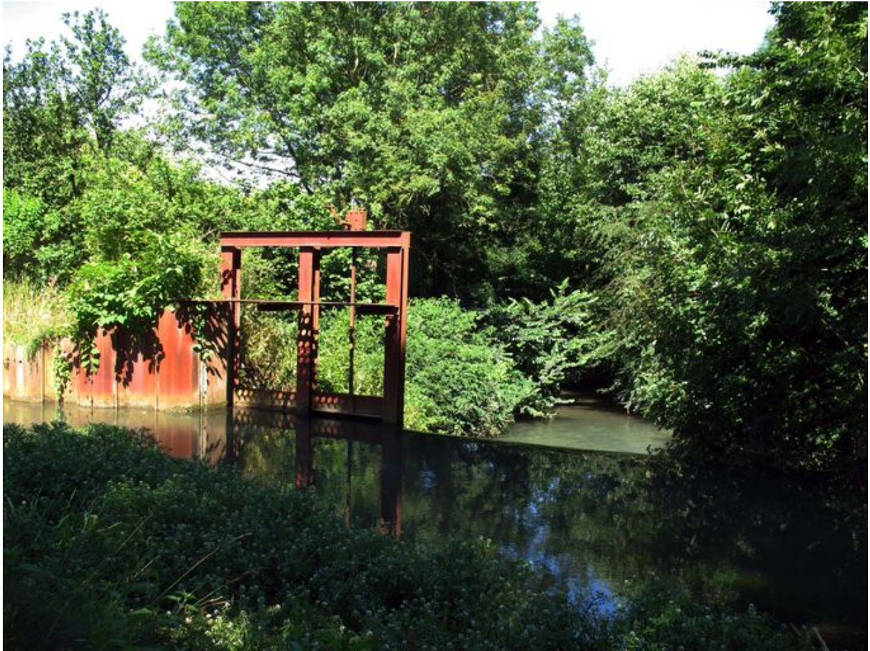
Vannage de décharge sur la dérivation de la Nièvre.
