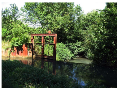
Vannage de décharge sur la dérivation de la Nièvre. Phot. Bertrand Fournier IVR22_20088015010NUCA
