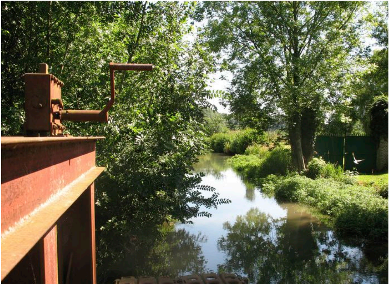
Dérivation de la Nièvre avec au premier plan la crémaillère du vannage de décharge.
