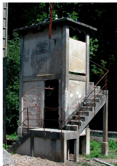
Vue du transformateur.
