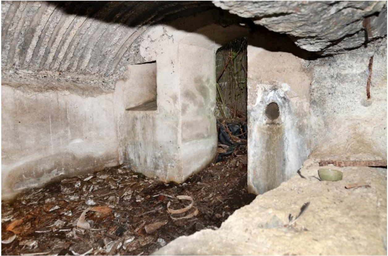
Entrée et baie sur le couloir de la seconde salle nord depuis la brèche entre les deux salles
