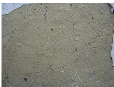
Détail du torchis et des sillons permettant une meilleure adhésion de l'enduit de finition. Phot. Inès Guérin IVR22_20078005312NUCA
