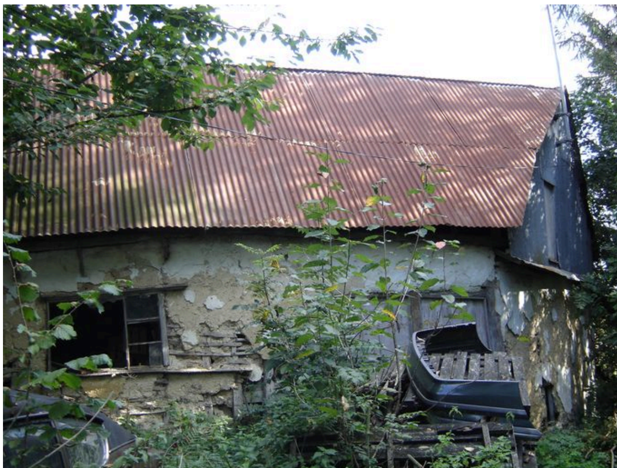
Vue du bâtiment au sud qui semble avoir été une étable depuis la cour.
