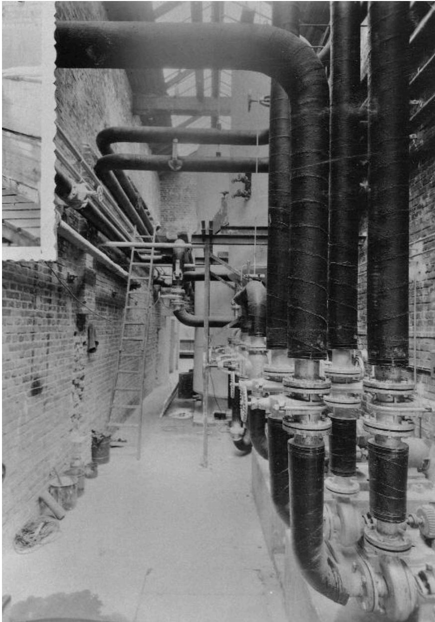
Tuyaux d'épuration, juillet 1953 (coll. part.).
