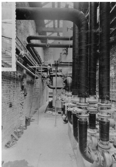
Tuyaux d'épuration, juillet 1953 (coll. part.). Phot. Philippot Jacques IVR22_19878000307XB
