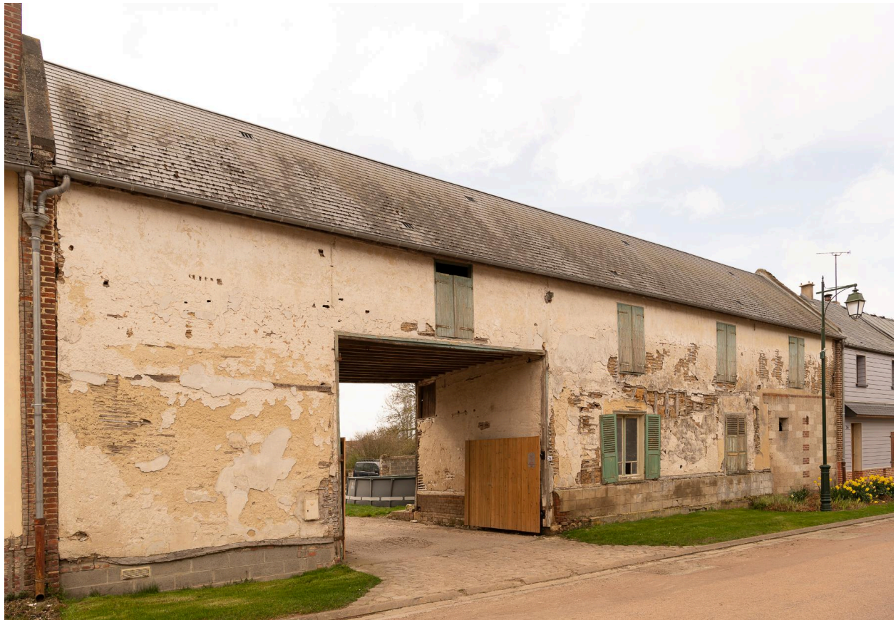
Logis sur rue avec entrée charretière et grange, n°34 de la Neuve-Rue, vue prise depuis le nord.
