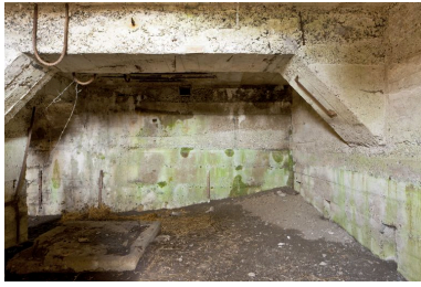
Salle secondaire, vers le nord. A gauche, le socle bétonné d'une pompe aujourd'hui disparue Phot. Jean-Marc Ramette IVR31_20145905428NUCA
