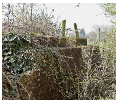
Au sud de l'édifice, massif de fixation des conduits d'évacuation d'eau Phot. Jean-Marc Ramette IVR31_20145905409NUCA
