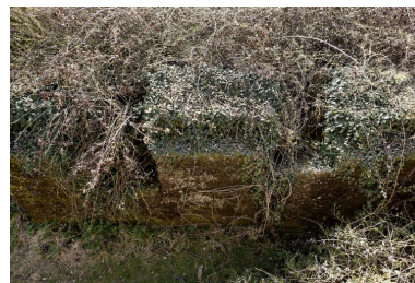
Au sud de l'édifice, massif de fixation des conduits d'évacuation d'eau Phot. Jean-Marc Ramette IVR31_20145905422NUCA
