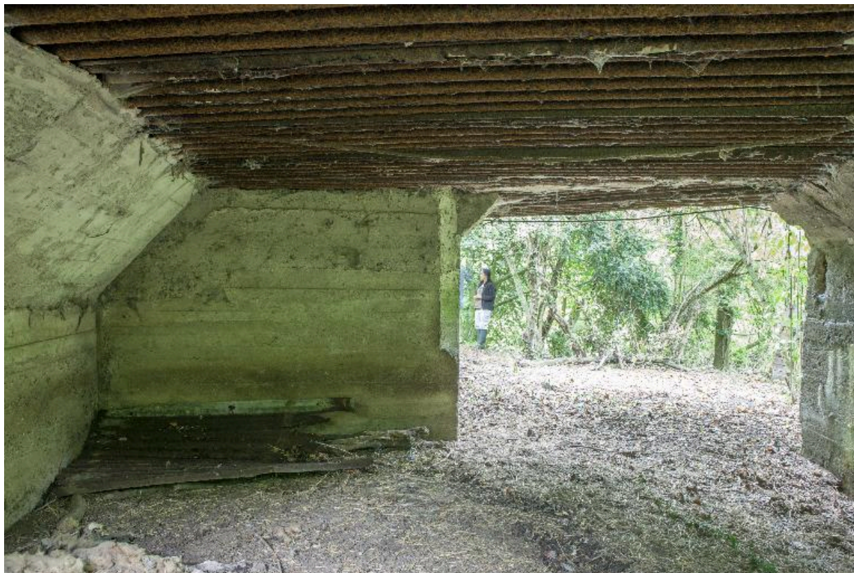
Sortie de la chambre de tir
