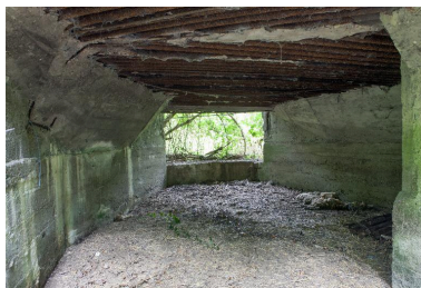
Vue en enfilade de la chambre de tir, vers le nord-ouest Phot. Pierre Thibaut IVR32_20165901063NUCA
