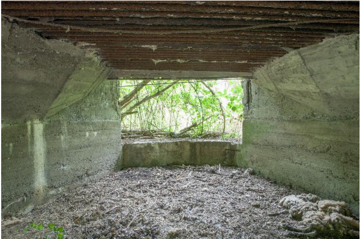
Sortie de la chambre de tir
