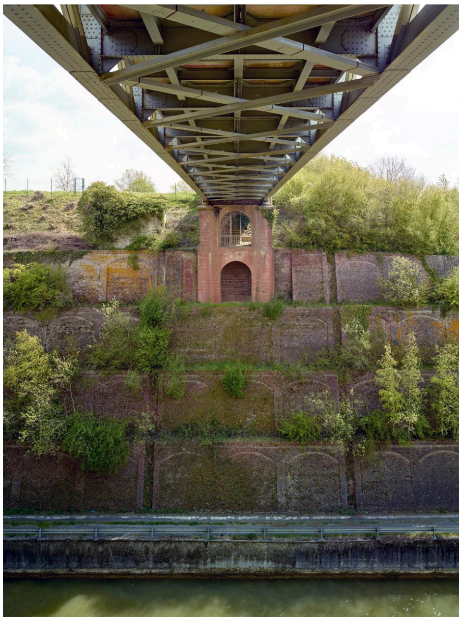
Vue sous le pont routier sud (depuis la rive est). Culée du pont, murs de soutènements en gradins.
