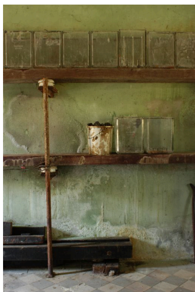
Série de récipients à batteries, mur nord de la la salle des machines. Phot. Thierry Lefébure IVR22_20036000286NUCA
