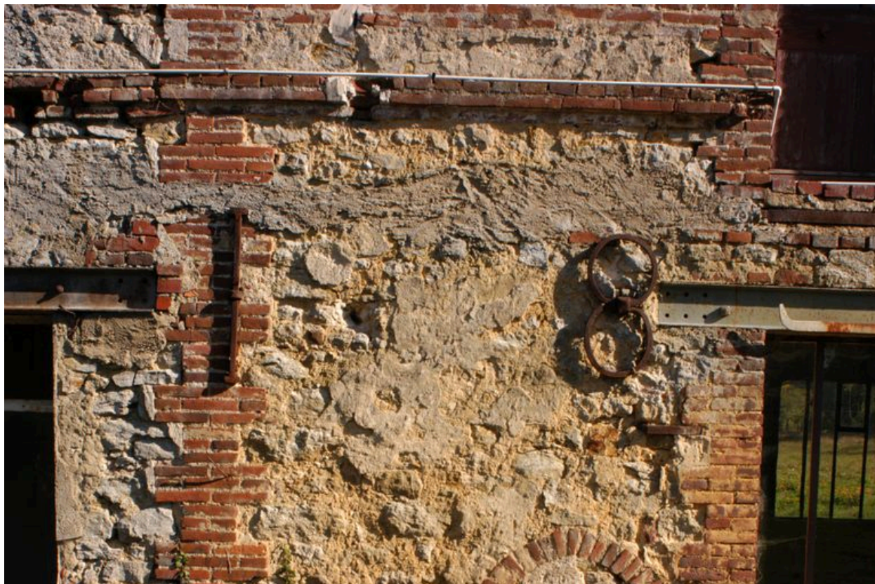
Détail de la date partielle en fers d'ancrage sur le mur ouest de l'atelier de fabrication.
