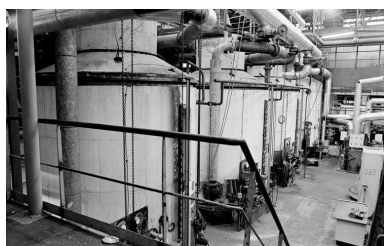
Atelier de fabrication (cristallisation) : vue intérieure. Phot. Benoît Dufournier IVR22_19936002274Z
