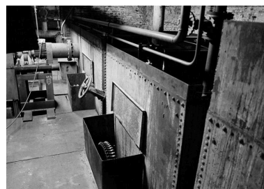
Atelier de fabrication (cristallisation) : vue intérieure. Phot. Benoît Dufournier IVR22_19936002276Z
