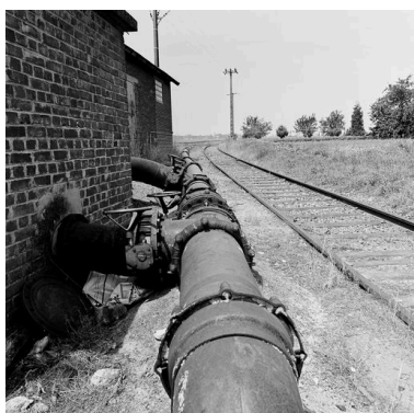
Station de pompage, canalisation vers l'usine. Phot. Patrick Glotain IVR22_19936000758X
