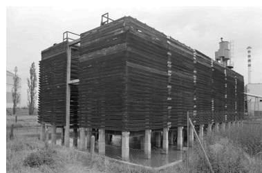
Réfrigérant : vue générale. Phot. Benoît Dufournier IVR22_19936002294Z
