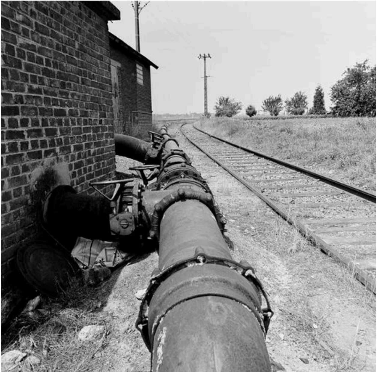
Station de pompage, canalisation vers l'usine.
