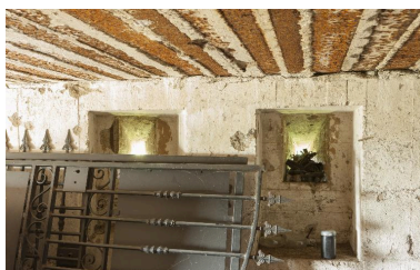
Vue intérieure de deux créneaux de fusillade situés dans l'élévation sud-ouest Phot. Jean-Marc Ramette IVR31_20145905586NUCA
