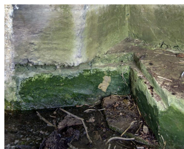
Détail de l'entaille à la base du mur qui permettait, peut-être, d'augmenter le débattement d'une pièce d'artillerie sur un chemin de roulement Phot. Jean-Marc Ramette IVR32_20175900498NUCA
