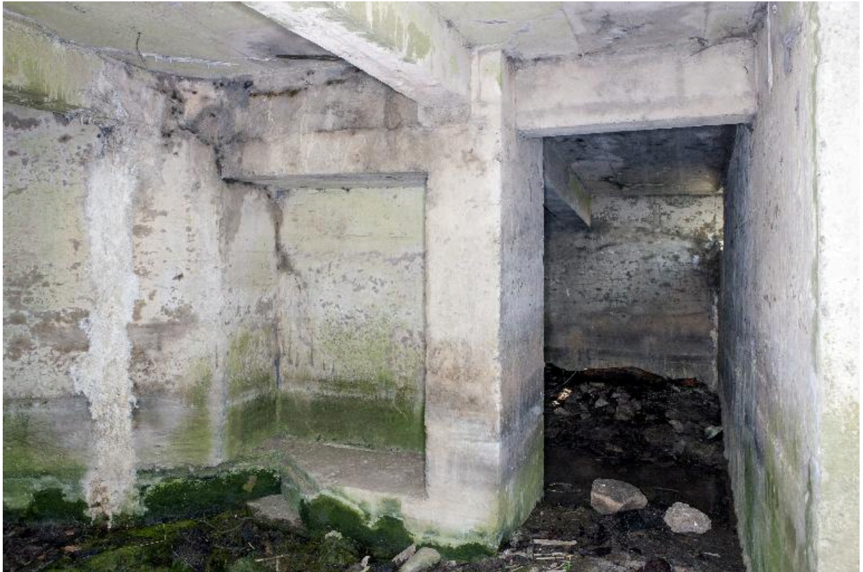
Vue intérieure, paroi est de la chambre de tir et accès à la soute à munition à droite.
