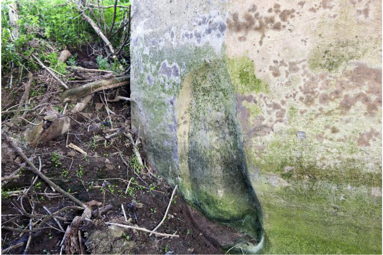
Détail de l'échancrure droite située à la base du mur près de la sortie de la chambre de tir (pour le blocage de l'affût du canon ?)
