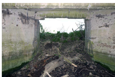
Intérieure de la chambre de tir, vers le front. On notera les échancrures à la base des murs permettant peut-être le blocage de l'affût du canon. Phot. Pierre Thibaut IVR31_20155901184NUCA
