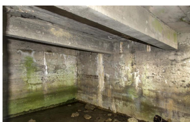
Les poutrelles de la soute à munitions depuis la chambre de tir. Phot. Jean-Marc Ramette IVR32_20175900500NUCA
