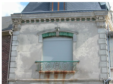
Détail de la baie avec garde-corps en fonderie, façade latérale gauche. Phot. Elisabeth Justome IVR22_20058003075NUCA
