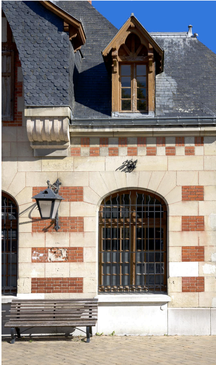
Détail d'une des ouvertures en plein cintre au rez-de-chaussée de la façade principale.
