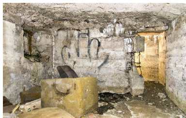
Vue intérieure de la salle sud. Au fond, le couloir en chicane de sortie Phot. Jean-Marc Ramette IVR32_20165901520NUCA
