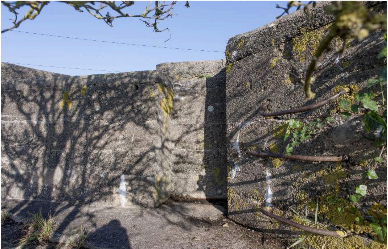
Echélons métalliques donnant accès au couvrement
