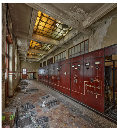
Vue intérieure de la salle des générateurs électriques, vue vers le sud. Phot. Thierry Lefébure IVR32_20238000071NUCA
