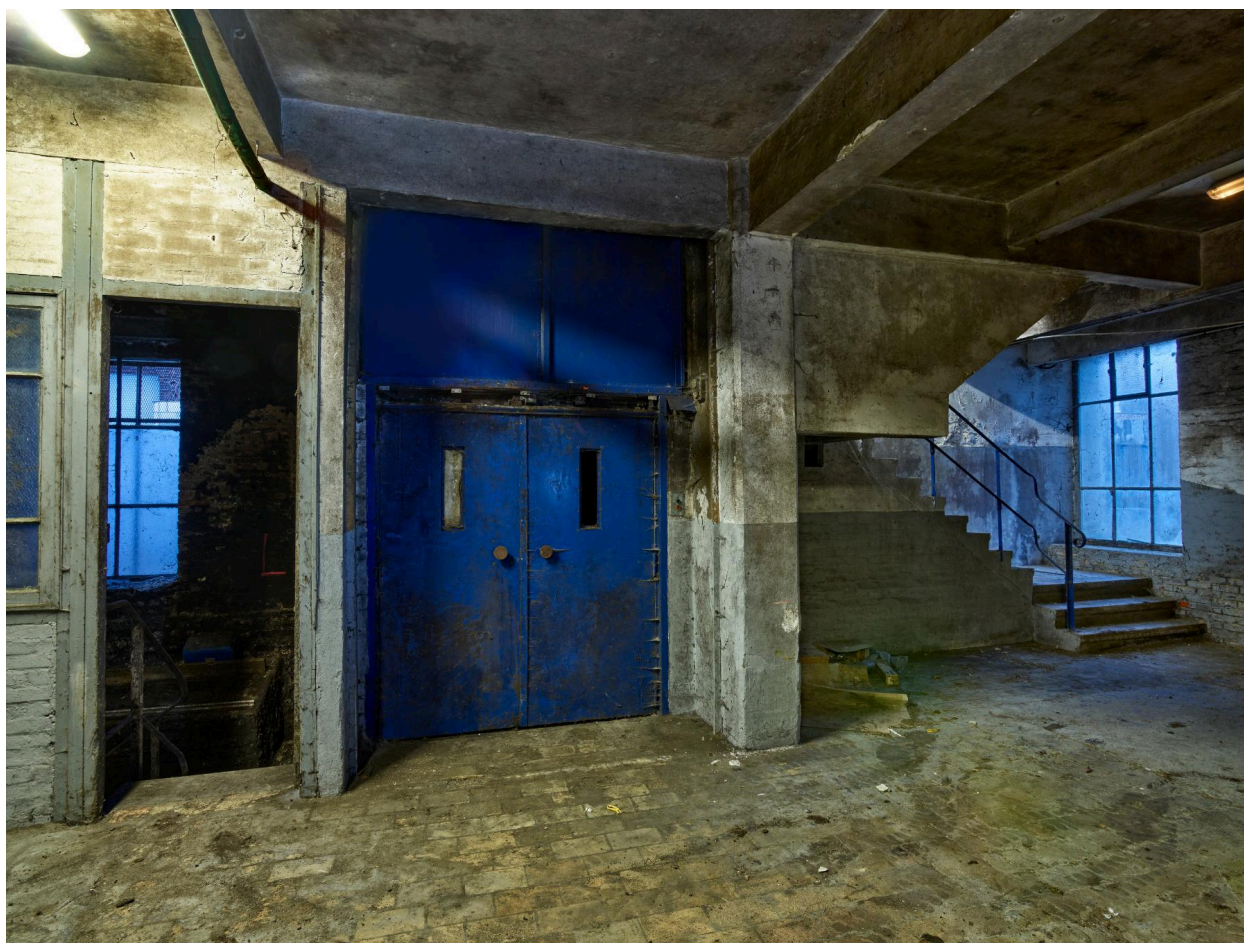
Bâtiment A, monte-charge depuis le rez-de-chaussée.
