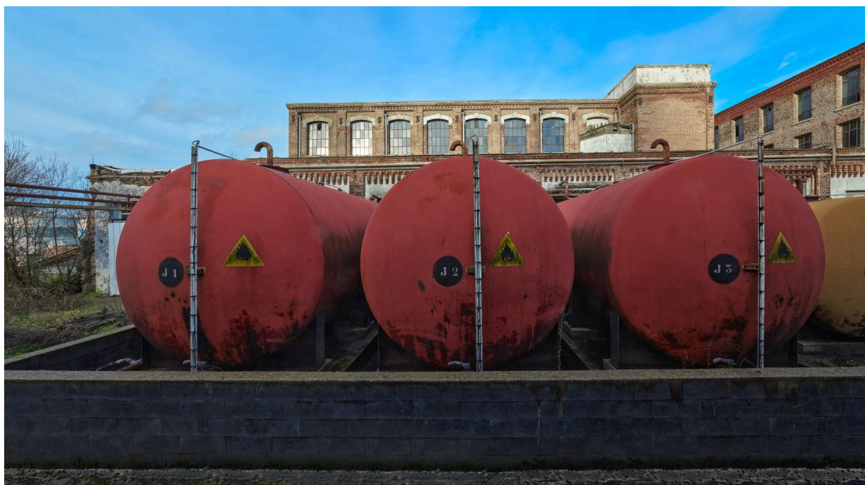
Vue d'ensemble des cuves horizontales situées à l'arrière du bâtiment K.
