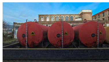
Vue d'ensemble des cuves horizontales situées à l'arrière du bâtiment K.
