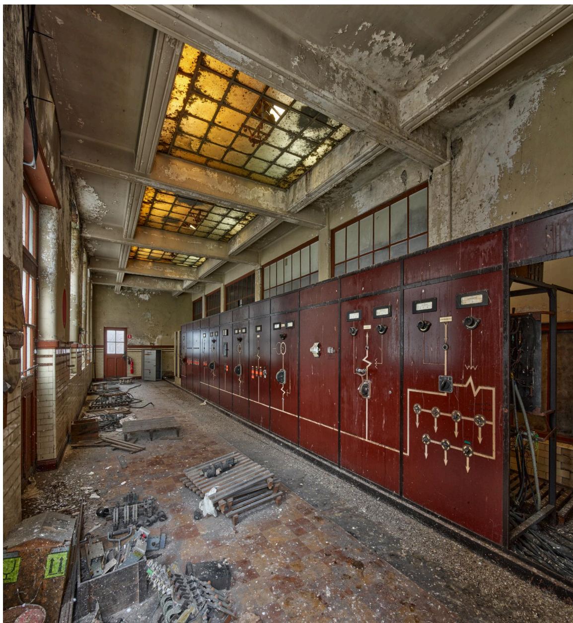
Vue intérieure de la salle des générateurs électriques, vue vers le sud.
