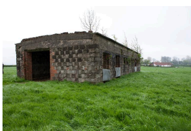
Bâtiment de montage. Vue générale prise depuis le nord-ouest. Phot. Pierre Thibaut IVR31_20126201678NUCA
