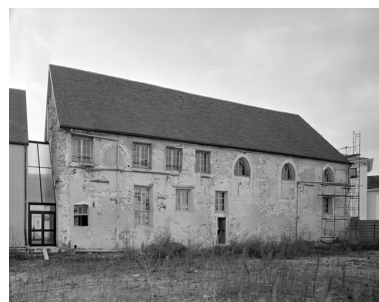
La face orientale de l'ancienne chapelle, en cours de travaux. Phot. Thierry Lefébure IVR22_19930201915V
