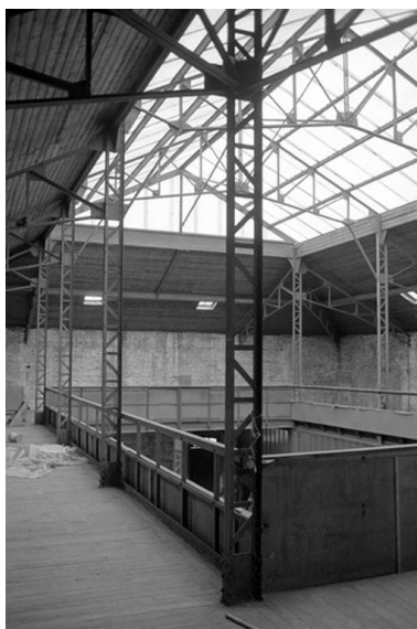
Atelier de fabrication de l'usine Buiret-Debeaurain, vue intérieure, en 1989. Phot. Francis Dubuc IVR22_19908000846Z
