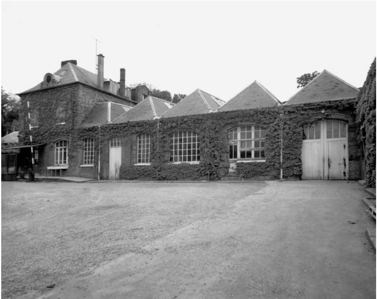
Tissage de jute. Vue d'ensemble sur cour de la conciergerie et de l'atelier de réparation attenant. Etat en 1988.
