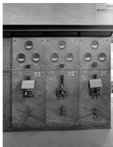
Armoire électrique en 1988. Phot. Thierry Lefébure IVR22_19888000688V
