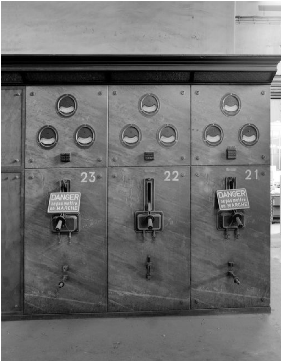
Armoire électrique en 1988.
