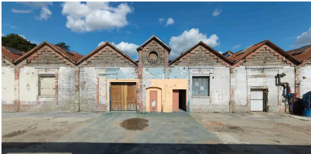
Pignon ouest, sur cour, des ateliers de tissage de jute, avec le couloir technique plus étroit, au centre.
