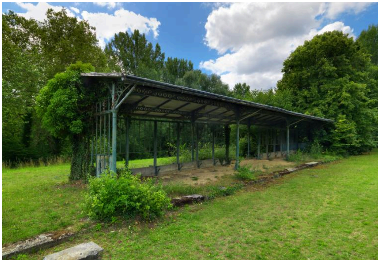
Marquise de l'abri des voyageurs sur le quai central entre l'emprise des anciennes voies.
