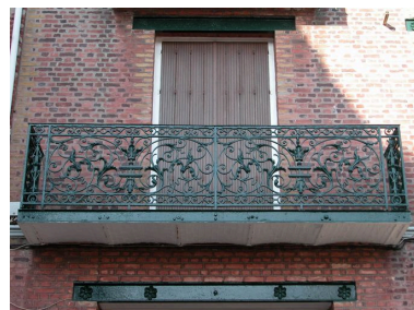
Détail du décor de fonderie du garde-corps de balcon situé au premier étage-carré. Phot. Elisabeth Justome IVR22_20058002535NUCA
