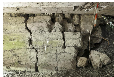
Partie du mur ouest, effondrée Phot. Jean-Marc Ramette IVR31_20145905202NUCA
