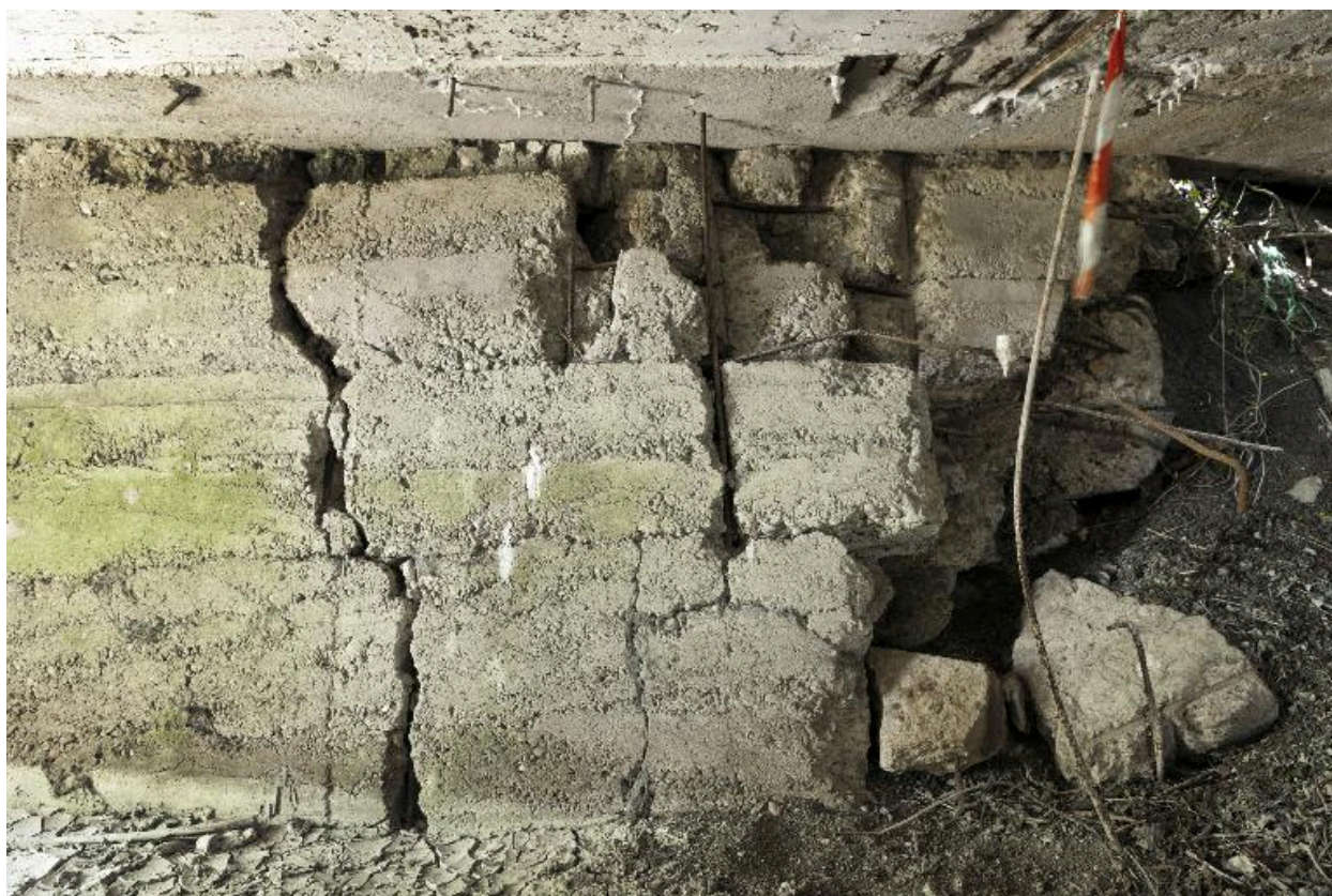
Partie du mur ouest, effondrée
